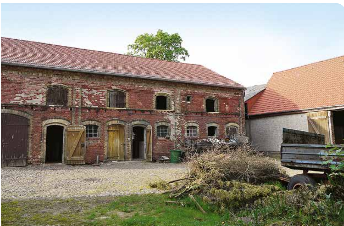
Vom Verfall bedroht: der Bauernhof am Dorfteich
