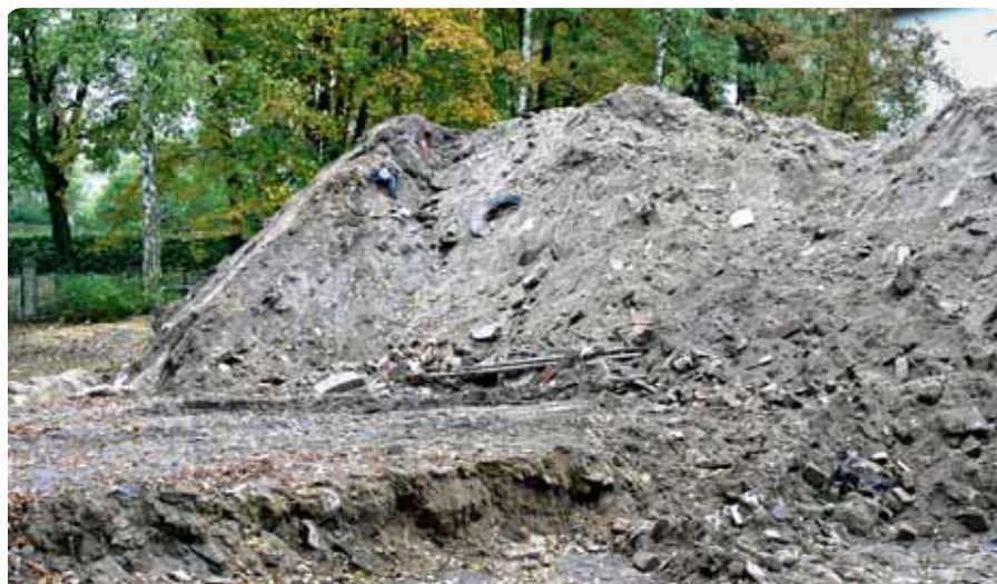
Beim umfangreichen Bodenaustausch waren sogar Autoreifen zu Tage gekommen.
