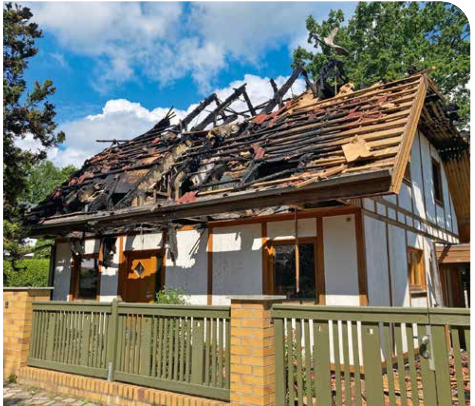
Völlig vom Brand zerstört: das Fachwerkhaus in der Metzger Straße
