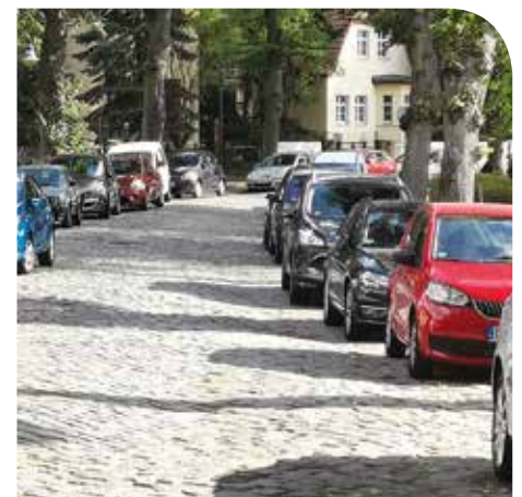
Muss saniert werden, jedoch soll das historische Bild erhalten bleiben: die Gartenstraße zwischen Dorfteich und altem Bauernhof.
