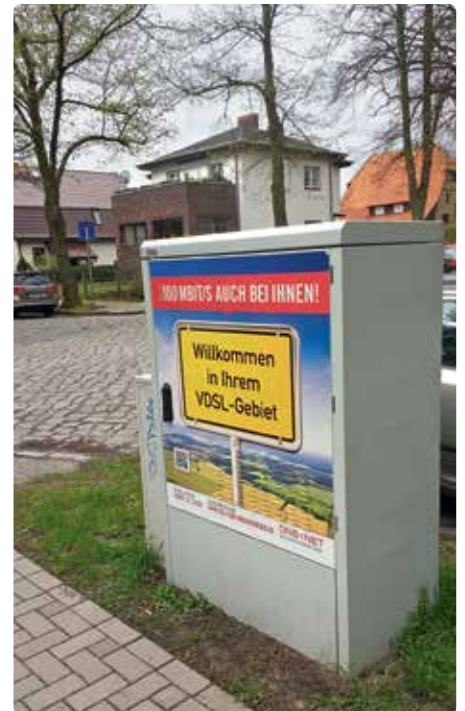
Kabelverzweiger in Glienicke
