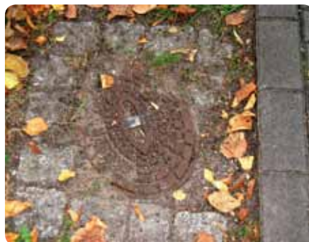
Neben Einläufen der Entwässerungsanlagen sind auch im Boden eingelassene Hydranten von Schnee und Eis zu befreien.
