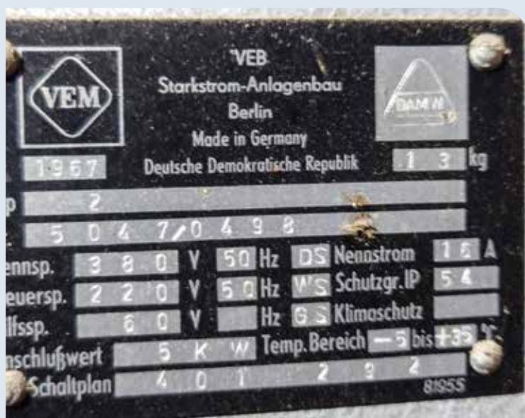
„Made in Germany“: Die Plakette auf der alten Sirenentechnik im Alten Rathaus zeigt, dass die Sirene 1967 im Volkseigenen Betrieb Starkstrom-Anlagenbau Berlin hergestellt wurde.
