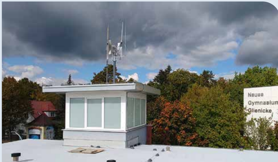
Neueste Technik auf dem Dach der Feuerwehr: Die elektronische Sirene mit vier Hörnern benötigt im Gegensatz zu den alten Modellen keinen Starkstromanschluss mehr und alarmiert zuverlässig auch bei Stromausfall.
