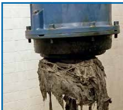
Probleme mit dem Abwasser
