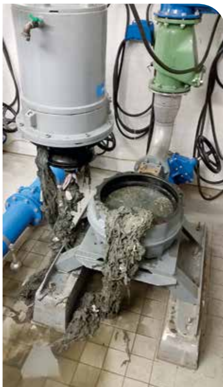
Verstopfung im Abwasserpumpwerk
