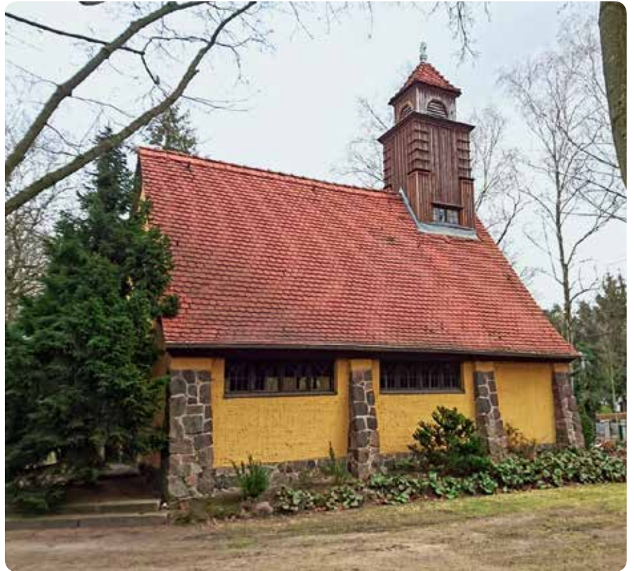
Sanierungsbedürftig: die Kapelle des evangelischen Friedhofes
