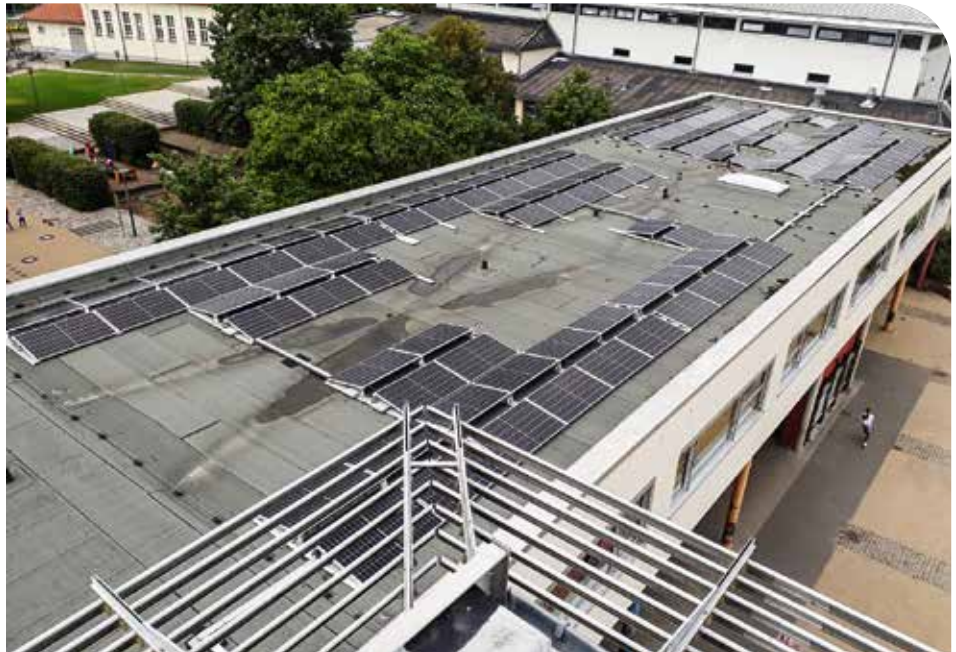
Hat ihren Betrieb bereits aufgenommen: Die Photovoltaik-Anlage auf dem Flachdach des Grundschulgebäudes (Haus 3)
