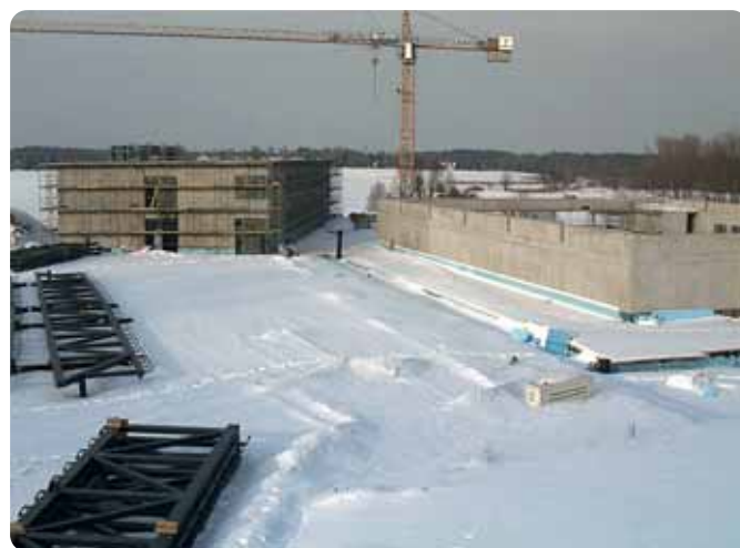
Am 9. Februar lagen die Dachbinder fürs Hallendach noch im Schnee. Foto: Verwaltung Mühlenbecker Land
