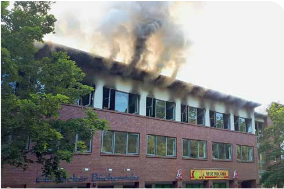
Totalschaden für das Gewerbe: Sowohl die Glienicker Bücherstube als auch die Neue Roland Apotheke können derzeit nicht mehr genutzt werden, ebenso der benachbarte Gemüse- und Obsthändler Kalas Fotos (2): privat
