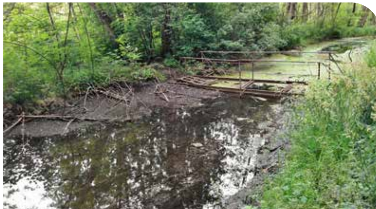
Kritischer Zustand: Der Kanalboden liegt in Teilen schon vollkommen frei. Fotos (2): Stefan Hesse
