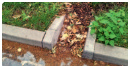
Bei sehr starkem Regen kann dieser Ablauf entscheidend sein: Er könnte zur Ursache für Überschwemmungen werden und muss daher dringend gereinigt werden.
