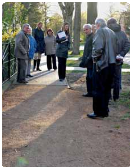
Die geplante Stahlkante und die oberste Schicht des Gehwegs fehlten zum Zeitpunkt der Besichtigung noch.
