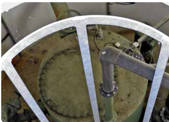
Der Kessel, durch den das Schmutzwasser fließt, bietet keine „Puffer“-Kapazitäten.
