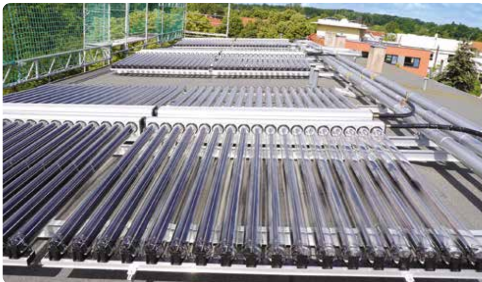
Schon seit acht Jahren auf dem Dach des gemeindeeigenen Wohnblocks in der Hauptstraße: eine Thermiesolaranlage
