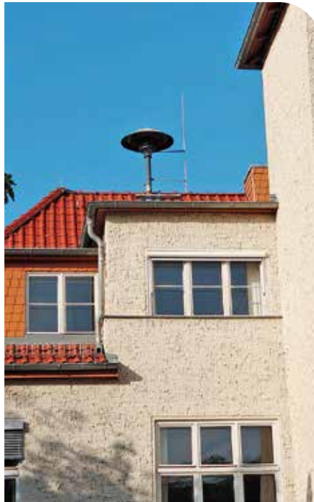
Funktioniert in Glienicke gut: die Sirene auf dem Dach des Alten Rathauses als Warninstrument
