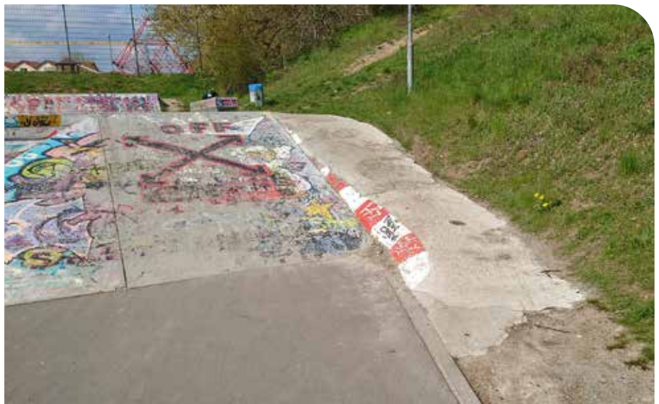
Ein Sanierungsfall: Das Provisorium auf der östlichen Seite der Skateranlage weist immer wieder Schäden auf und ist zu steil.
