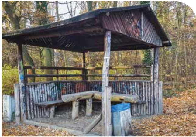
Der Unterstand in der Kindelwaldpromenade verfällt zusehends. Ein Instandhaltungs- und Pflegeplan könnte Abhilfe schaffen. Foto: privat
