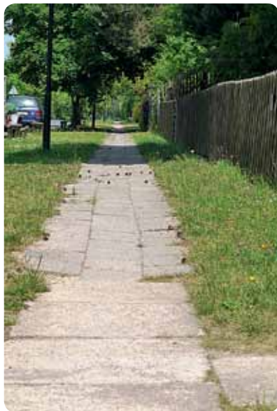
Der Fußweg in der Heinrich-Heine-Straße ist schadhaft und soll teilweise erneuert werden.
