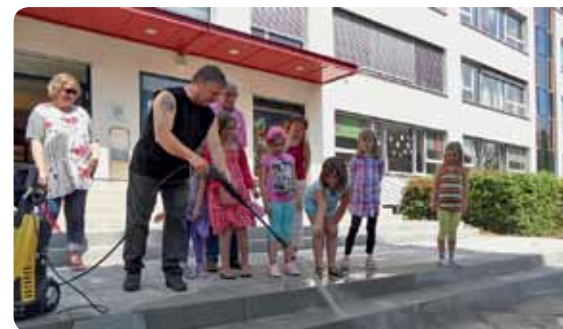
In den Sommerferien wurde die stark beschädigte Außentreppe vom Hort „Coole Kids“ saniert.
