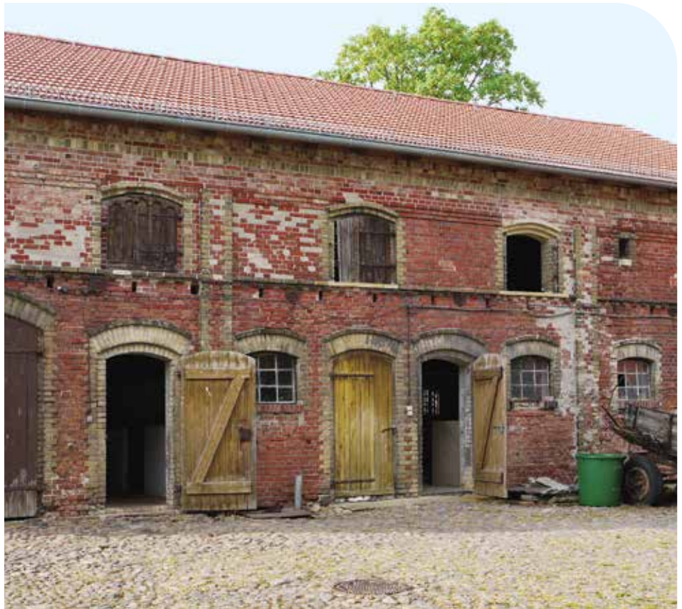
In einem maroden Zustand: der Bauernhof
