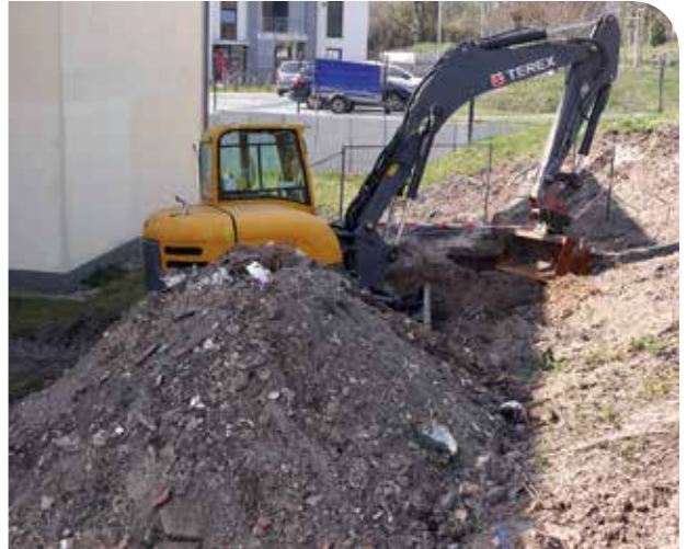
Bau des Jugendclubs verzögert sich: Arbeiter fanden Müllablagerungen im Erdreich.
