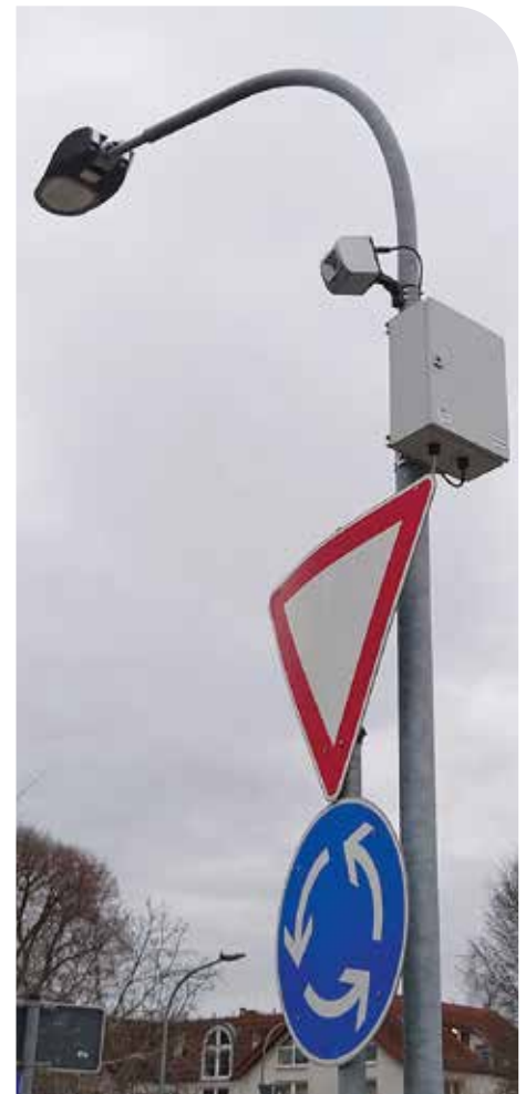
Moderne Technologie: Die Straßenbeleuchtung kann an die jeweilige Verkehrssituation angepasst werden.
