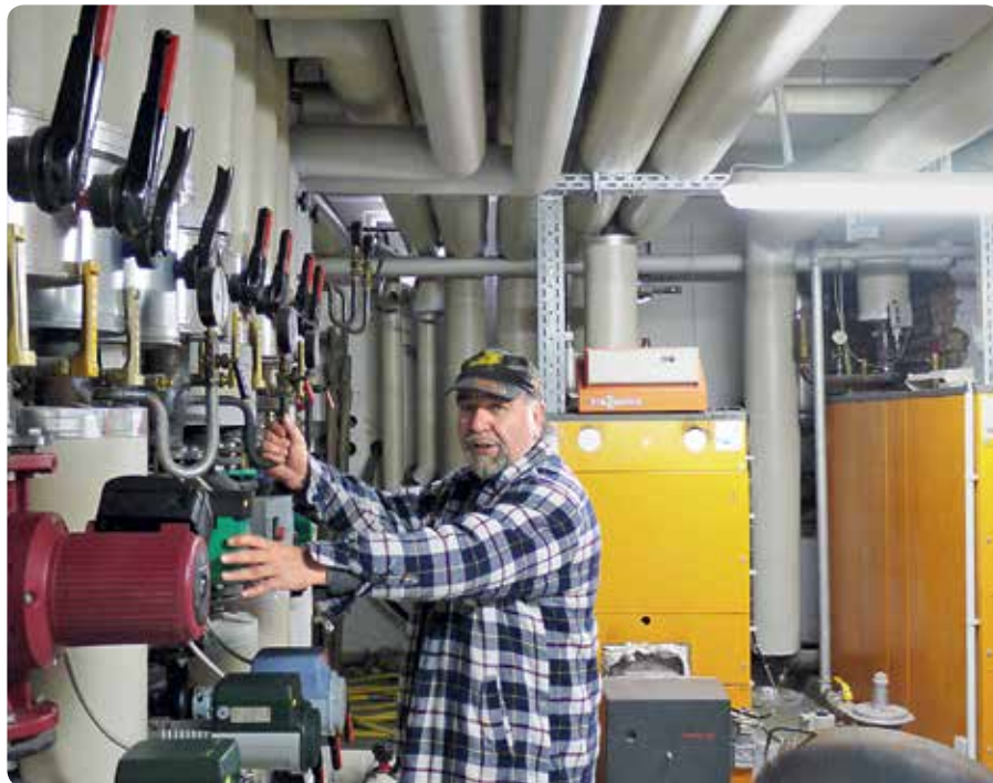
Im Heizraum der Grundschule hält bald modernere Technik Einzug.
