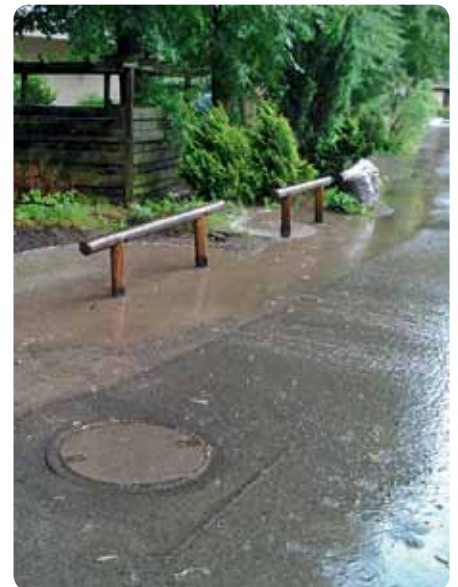
Problembereich Goethestraße – Charlottenstraße – Elisabethstraße: Ungehemmt fließt hier das Wasser die Straße entlang. Foto: privat
