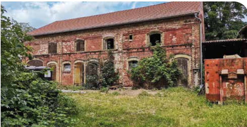
Angesichts der Baufälligkeit des Bauernhofes ist eine zeitnahe Sanierung notwendig.
