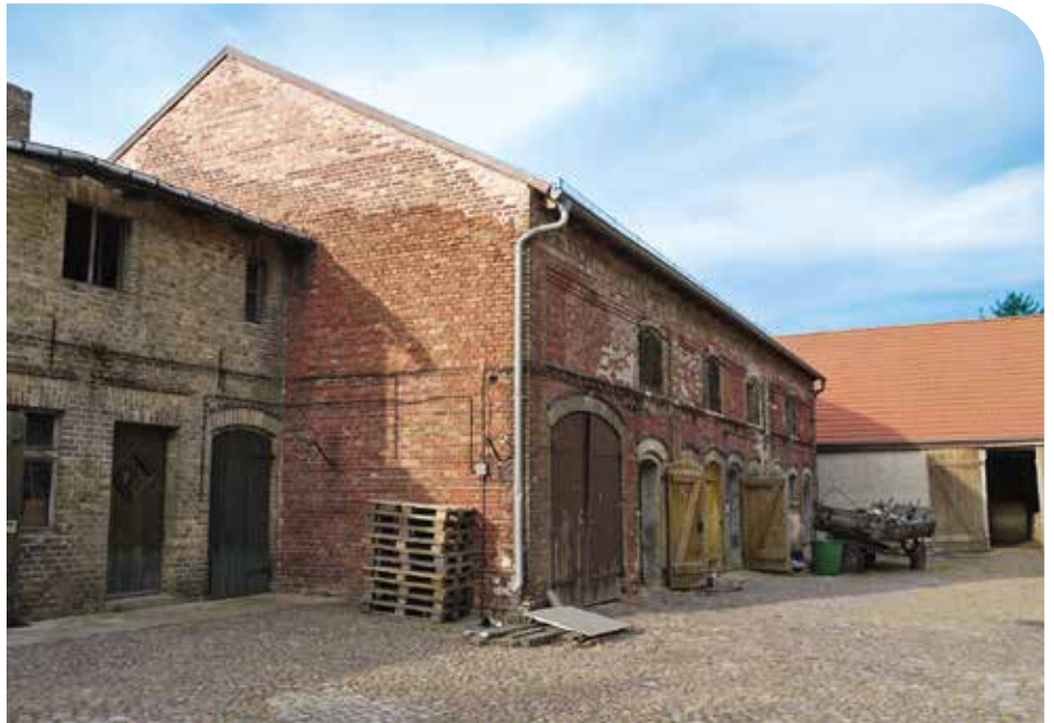
Befinden sich in einem katastrophalen Zustand: die Stallungen des Bauernhofes am Dorfteich
