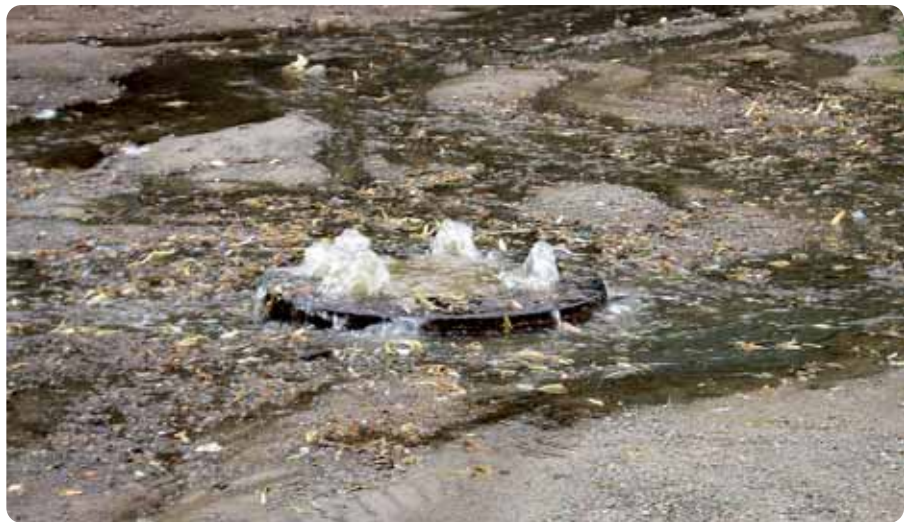
Die Breitscheidstraße steht im Zusammenhang mit der Kindelwaldsiedlung ganz oben auf der Dringlichkeitsliste. Foto: Büro UIC Werder
