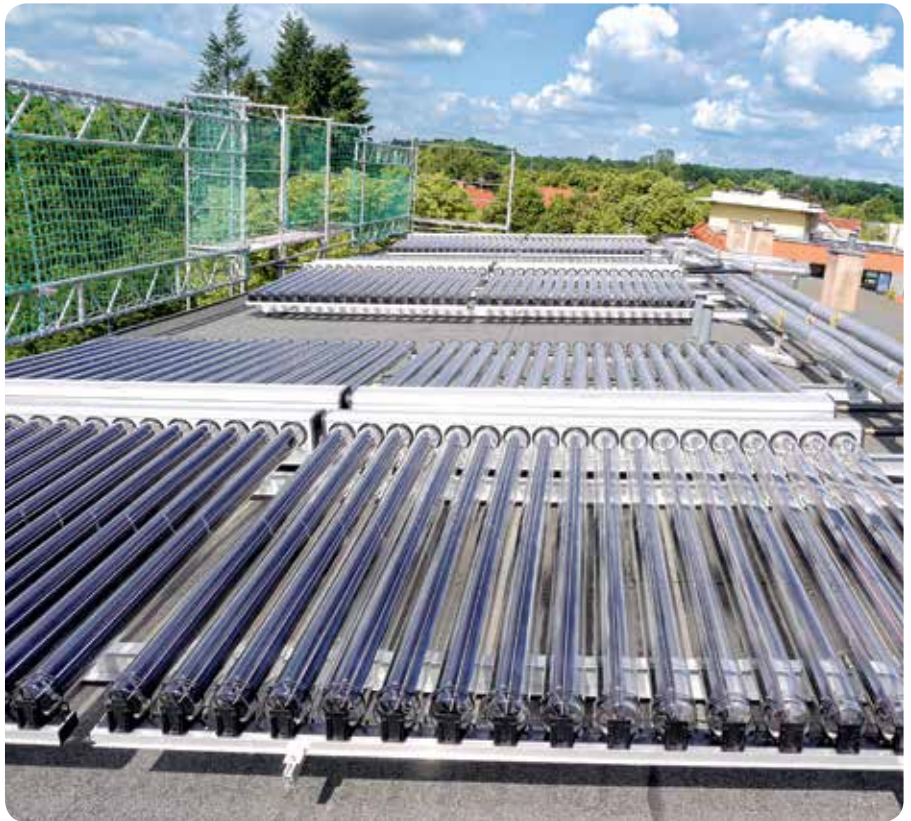
Die Anlage umfasst 720 Vakuumröhrenkollektoren.
