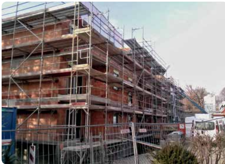
Begrüßenswerte Initiative des Bürgermeisters: Entsteht hier bald kommunaler und barrierefreier Wohnraum für die Gemeinde?
