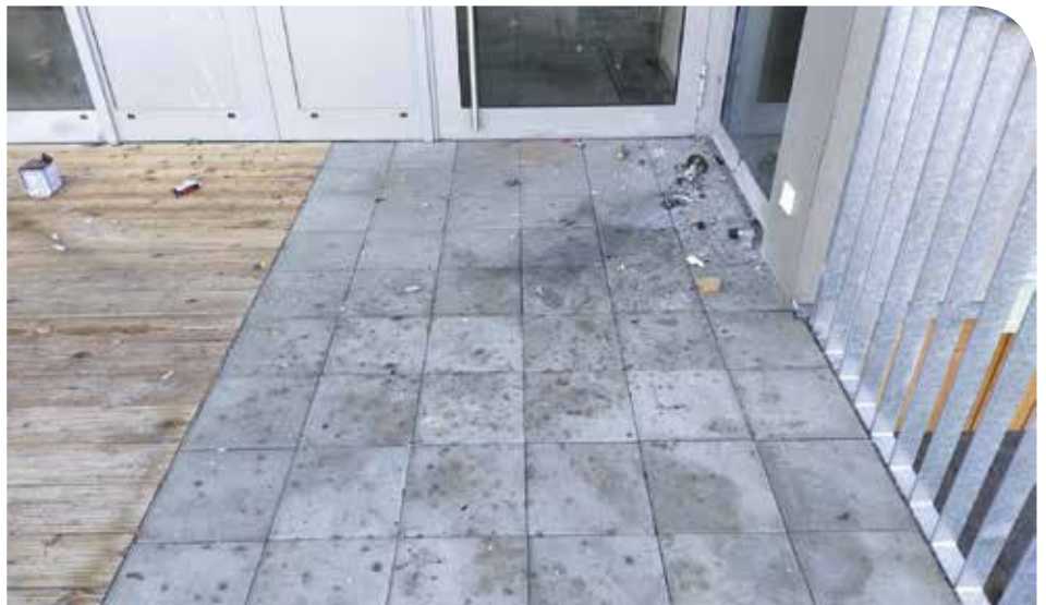
Reste eines abgebrannten Feuerwerks: Sowohl der Zugang als auch die Terrasse des Jugendclubs sind mit Schmauchspuren übersät.
