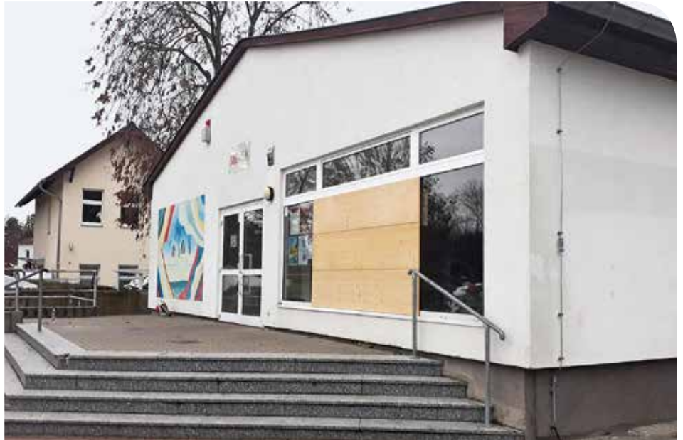
Kaputt: Die zerstörte Fensterfront musste Anfang Januar provisorisch durch Spanplatten ersetzt werden.
